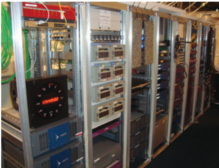
Фото 5. Стойки с оборудованием
