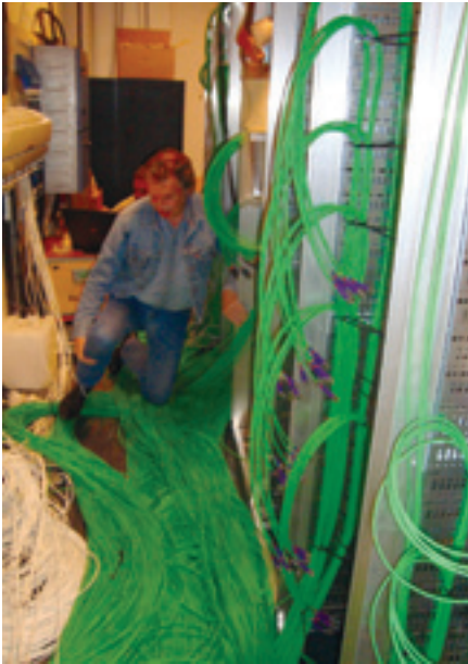
Фото 1. Подключение кабелей к стойкам вещательной аппаратуры
