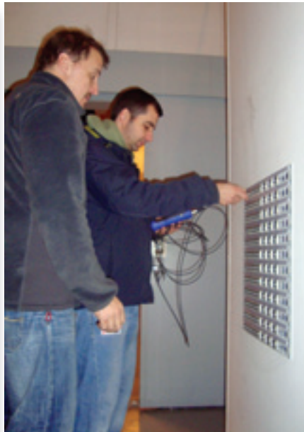
Фото 4. Тестирование одной из 160 коммутационных панелей
